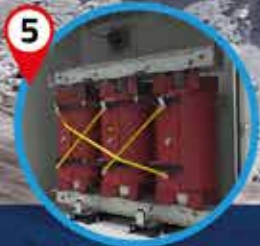
TRANSFORMADORES EN SECO
